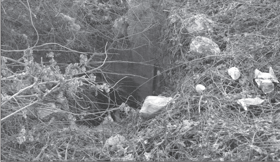
Скица 38. Запушен пропусник у насељу Шуљковац (клизиште КБ 149). Figure 38. Clogged bandpass in the settlement Šuljkovac. Landslide КБ 149
